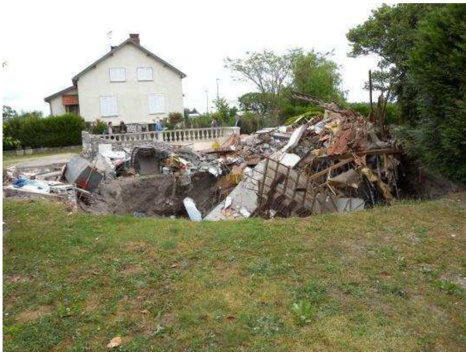
Maison effondrée à St-Pryvé St-Mesmin en 2010 - © DDT 45
